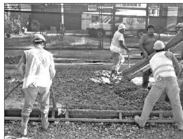
Diferentes calles y avenidas fueron reparadas. La inversión total ascendió a los 100 millones de pesos.
